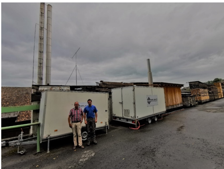
Abbildung 3: Provisorische mobile Ölheizung; im Hintergrund zwei Kamine der Holz-Schitzelheizung
