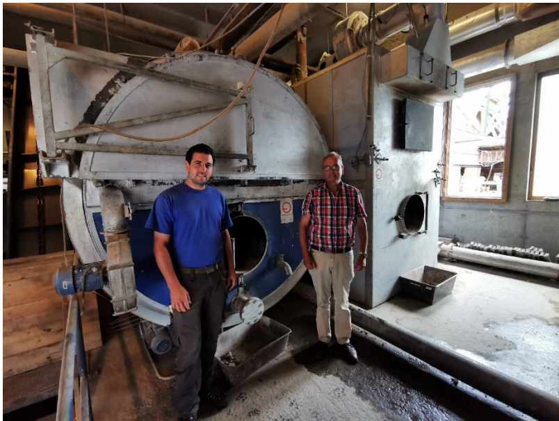
Abbildung 2: Die beiden Holz-Heizkessel wurden mechanisch für den Betrieb untauglich gemacht
